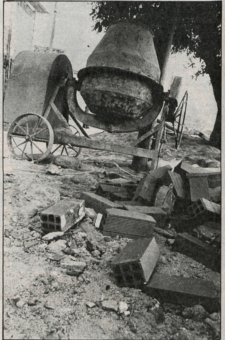
El coste de las obras de asfaltado se eleva a más de once millones de pesetas
