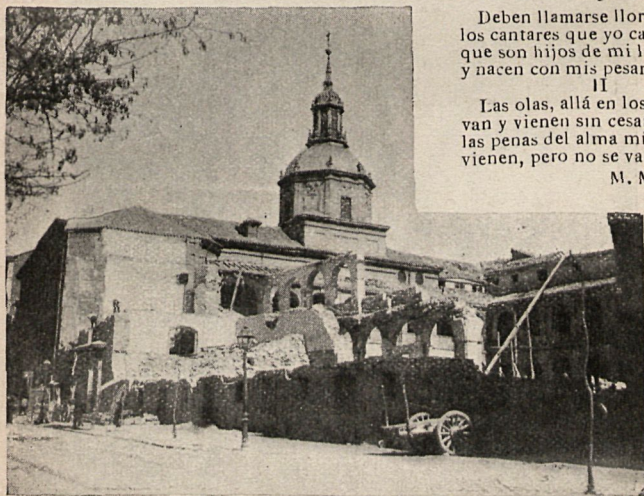
ANTAÑO—DERRIBO DEL HOSPITAL DE SAN JUAN DE DIOS (MADRID) Inst. de D. J. Padró Grané.
