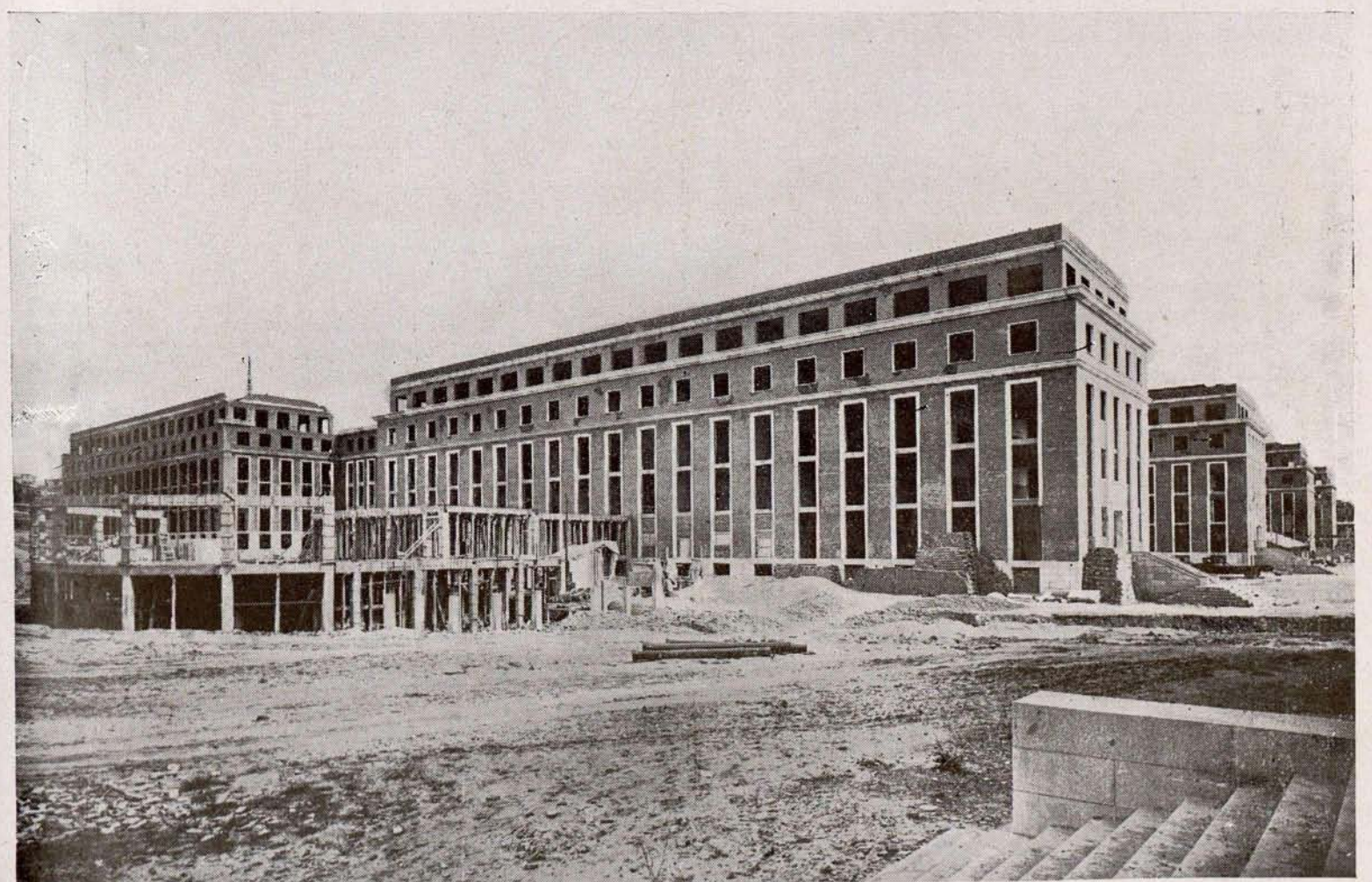
La Ciudad Universitaria, en construcción en Madrid. Fachada lateral izquierda de la Facultad de Medicina y sala de demostración.
