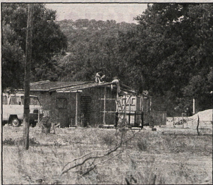
La piqueta actuará contra las edificaciones que no tengan licencia
