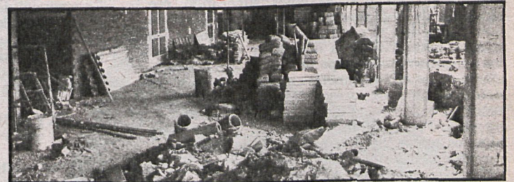
Los escombros impiden a los niños utilizar el patio
