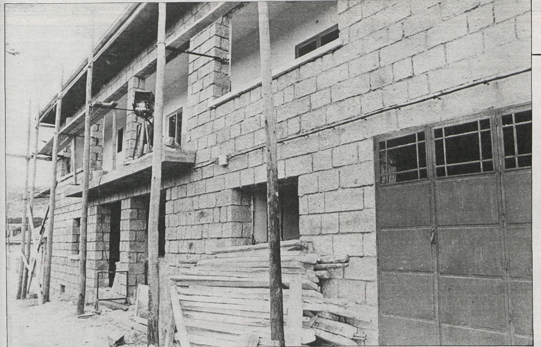
La Casa de la Cultura de Zarzalejo —construida por los propios vecinos— es una de las obras que se desarrollan actualmente en Zarzalejo
