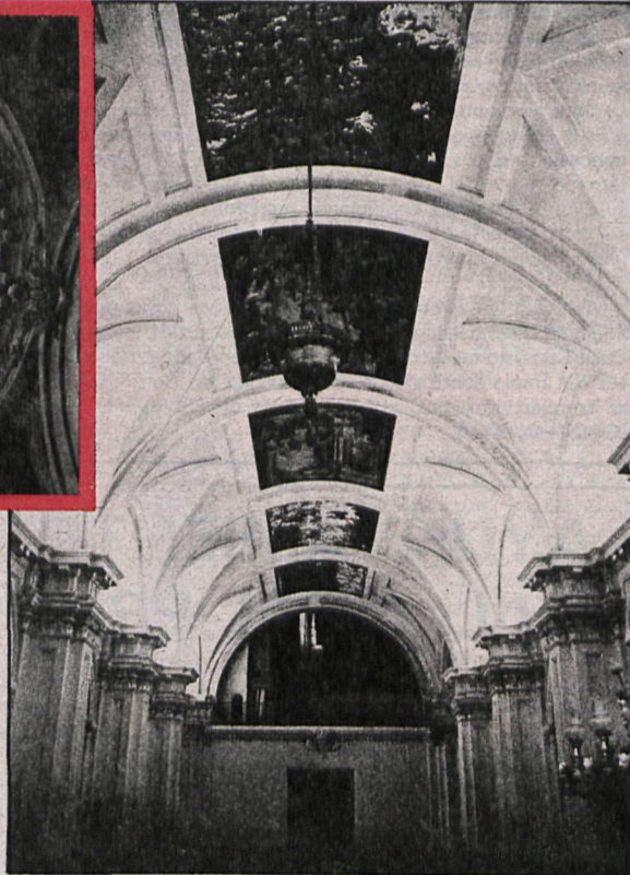
Aspecto parcial de la nave central, cuya restauración está prevista en la segunda fase
