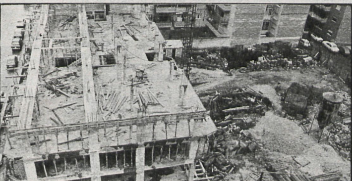
Este es el estado actual del bloque 11 de parque Fátima, cuyas obras han sido detenidas por el Ayuntamiento
