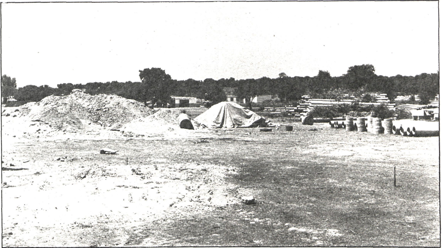
Las obras de la urbanización Las Hoyas han levantado una fuerte polémica por su posible ilegalidad, aunque el alcalde de Villa del Prado, José Luis Perlado, dice que está todo legalizado
